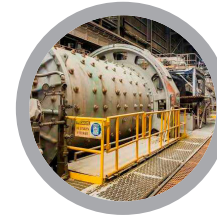
PROCESAMIENTO Y CONCENTRACIÓN DE MINERALES
